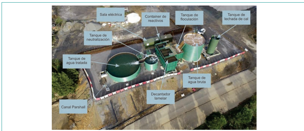
Figura 23. Planta de tratamiento de aguas ácidas en Touro. Nota: La planta trata las aguas ácidas originadas por la minería histórica que cerró en 1987. Fuente: (Atalaya Mining, n.d.).
